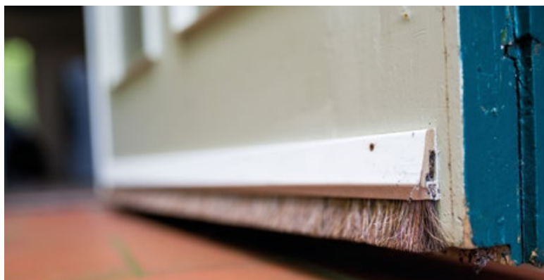
Durch Spalten und Ritzen zieht es und Wärme geht verloren – eine einfache Abdichtung vermeidet dies bei Außentüren.
