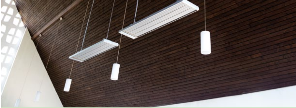
Infrarot-Deckenstrahler und LED-Leuchten hängen gemeinsam unter der Decke der Friedhofskapelle und sorgen energiesparend für angenehme Wärme und angenehmes Licht.
