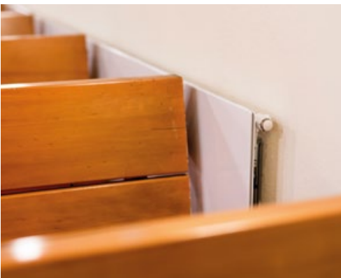
Schmale Heizkörper an den Wänden verteilen die erneuerbare Wärme.
