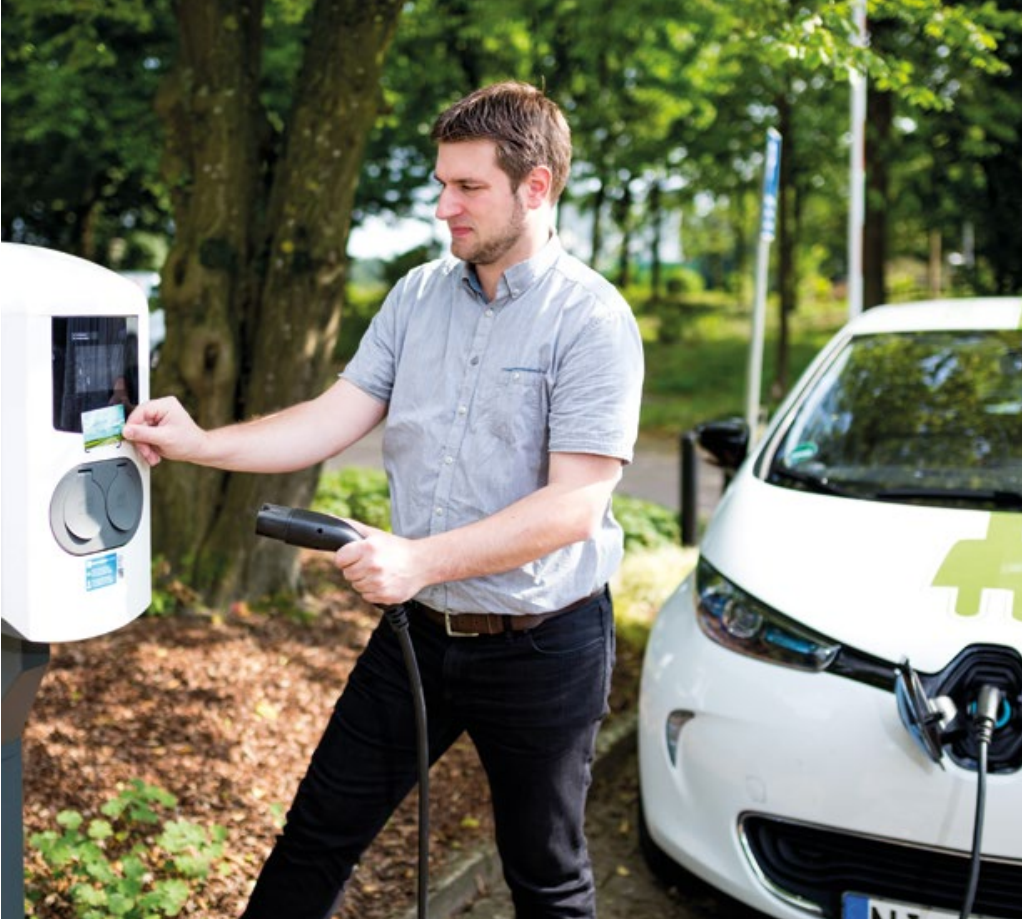
Für Amadeus Bürgel, dessen Firma die Ladestation installierte, war es nicht die erste Ladestation – doch es ist die erste in der Landeskirche.
