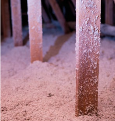
Eine einfache Einblasdämmung aus Zellulose auf dem ungenutzten Dachboden hilft dabei, dass die Wärme in den darunter liegenden Räumen bleibt.
